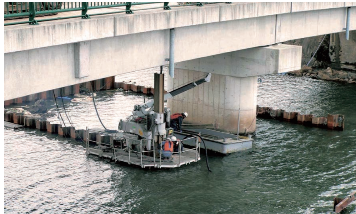
上部障害クリア工法による空頭制限下での橋梁拡幅工事(下部工)
